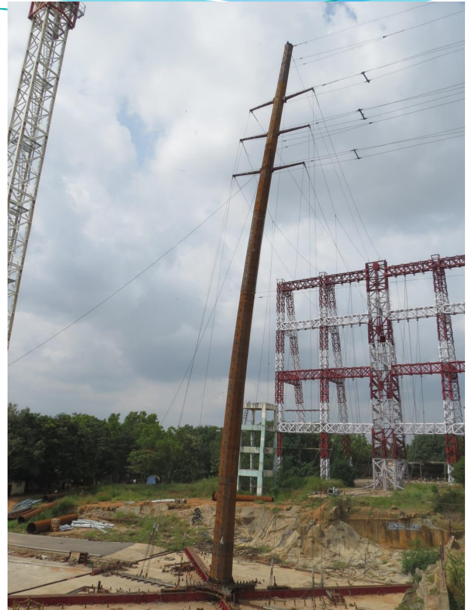
220 kV D/C Pole
