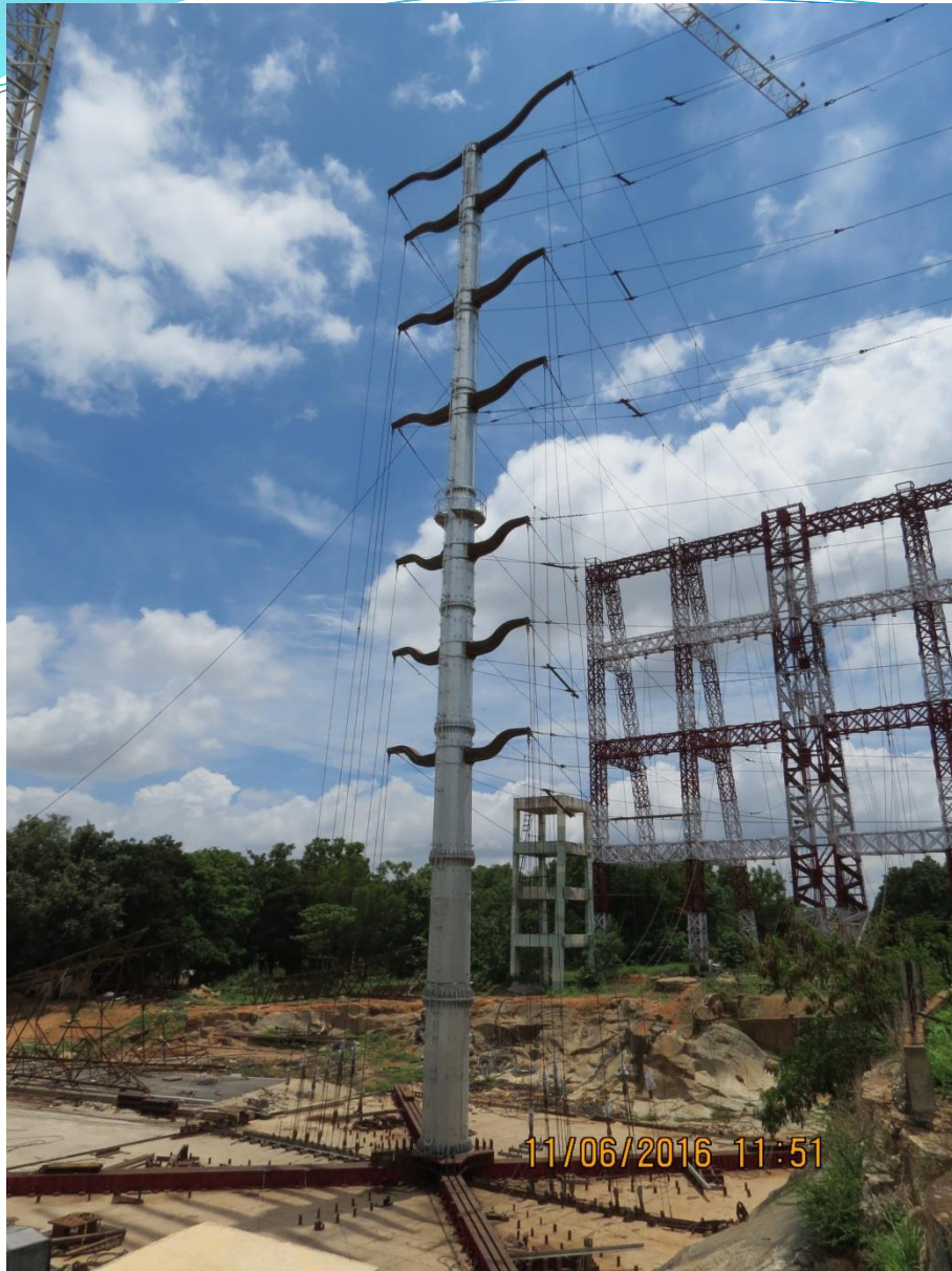
275/132 kV M/C Pole
