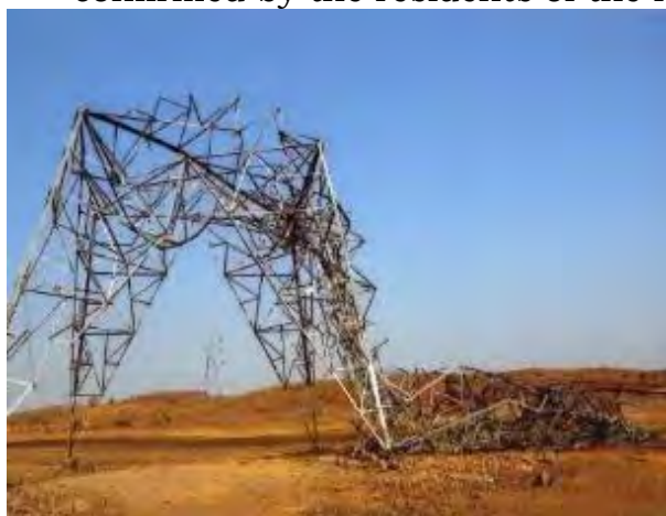
Tower loc. No. 167 (FD0+10)
